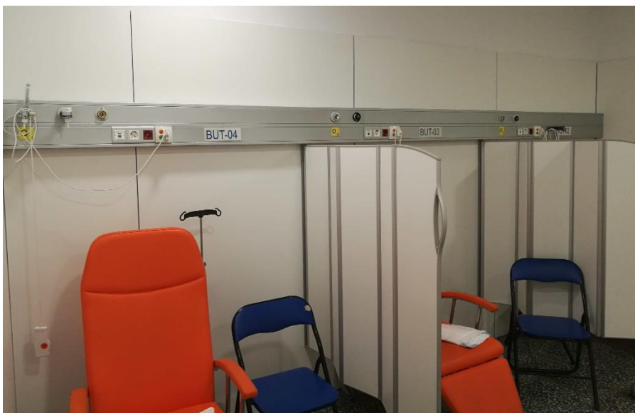
Fig. 25- Área de recuperación, con canal montada de superficie
