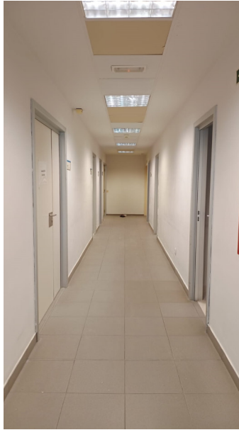
Figura 19. Fotografía interior de la zona de personal (fuente: fotografía realizada durante visita anterior a la reforma).
