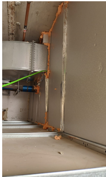
Figura 23. Fotografía interior de la sectorización provisional en falsos techos mediante panel de espuma rígida (fuente: fotografía realizada durante visita de obra).
